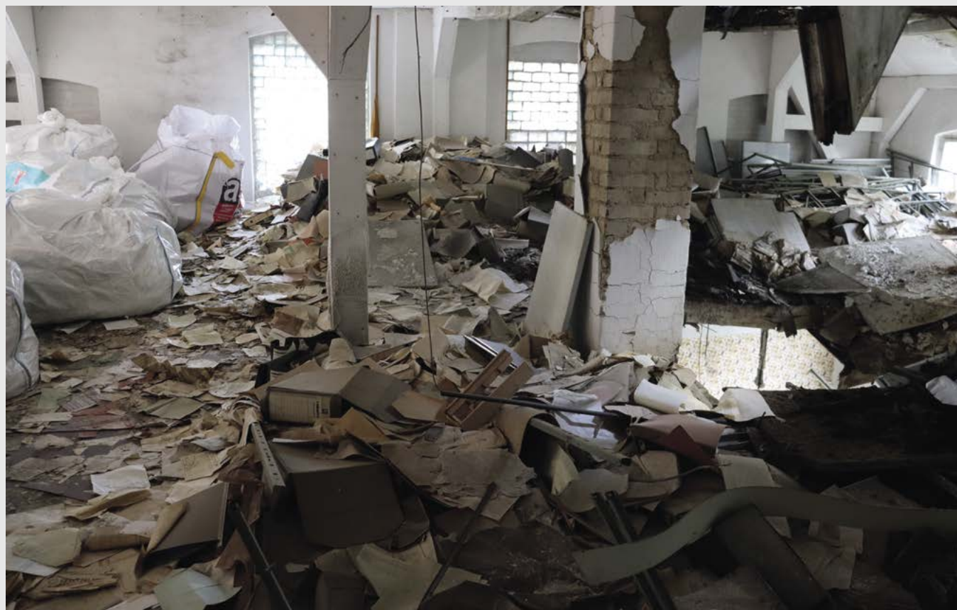
Des archives de la célèbre fabrique de tapis Halbmond à Oelsnitz (Saxe) dans des bâtiments abandonnés et voués à la destruction, juillet 2021 © Nicolas Offenstadt
